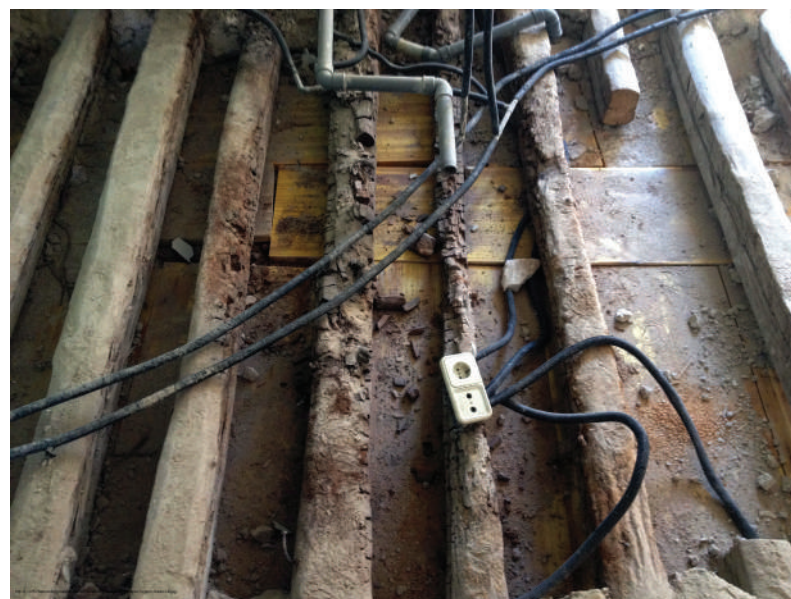
Fuente: http://j-l.es/farfanestella/rehabilitacion/wp-content/uploads/2012/06/apeo-forjado-madera-6.jpg Figura 1. Ejemplo daños por falta de mantenimiento
